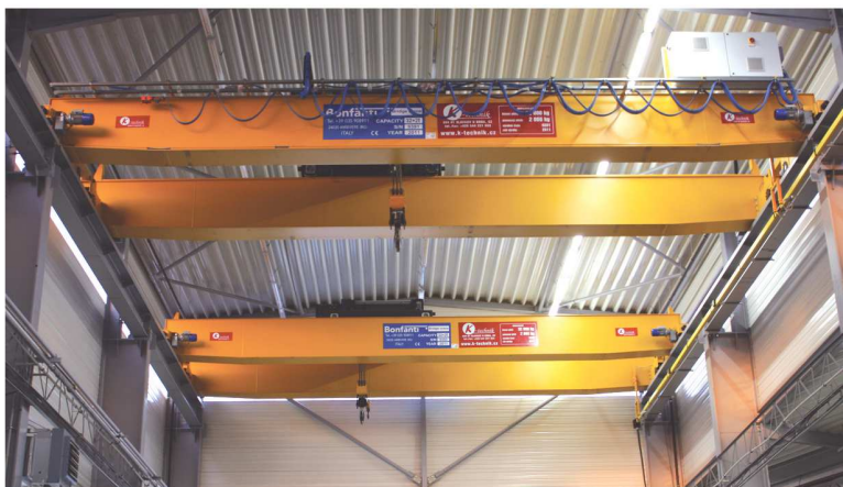
Mostové jeřáby 32t pracující v tandemu
